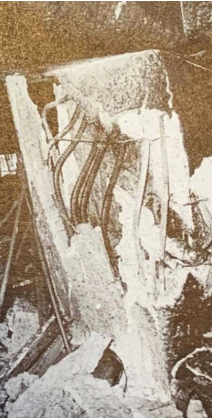
Utknekket betongsøyle i underetasjen i ferdigvarelageret. Bemerk armeringen!
