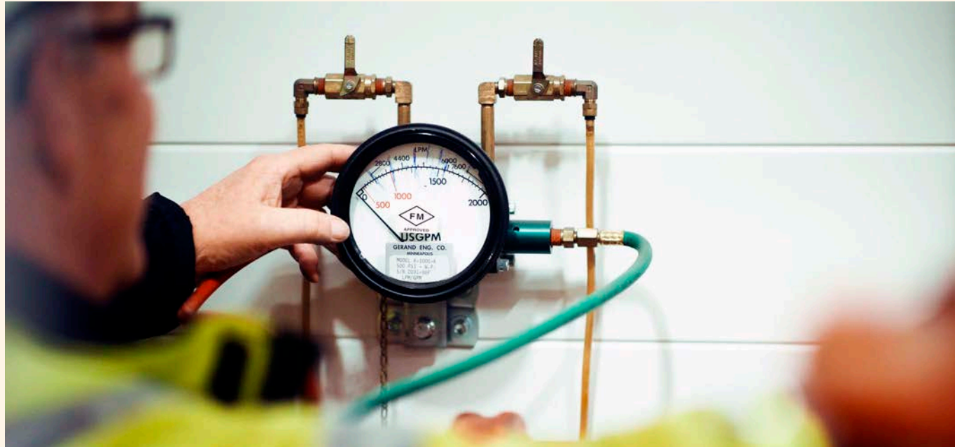
I mange år hadde brannvernforeningen monopol på kontroll av sprinkler- og brannalarmanlegg.
