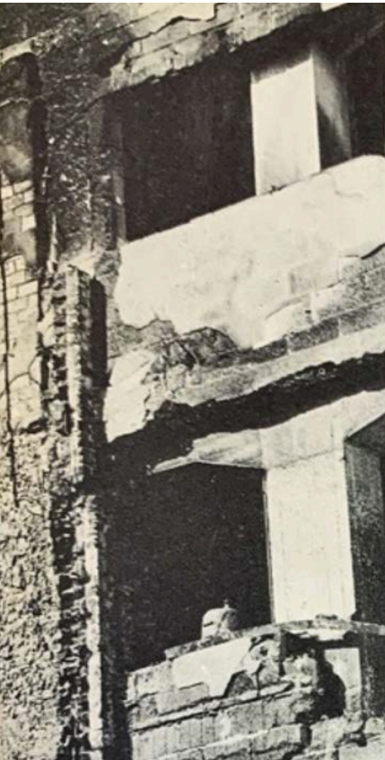
Detalj fra vest-veggen av malingfabrikken. Teglstainen er sintret i overflaten.
