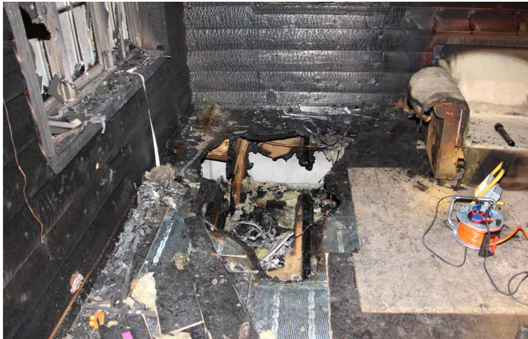
↑ Bildet er fra en nyere hytte og viser resultatet av en brann som følge av tildekket gulv med varmemefolie. Folien var lagt direkte under parkett (sandwichgulv).
