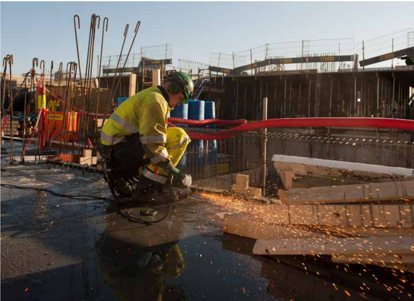
← Gnisten fra en vinkelkutter kan antenne brennbart materiale i nærheten av arbeidsplassen.
