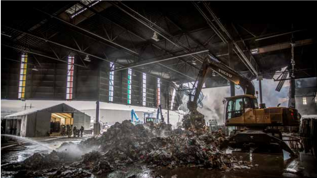
← Det kan være utfordrende å finne brannårsaken i store avfallsanlegg.
