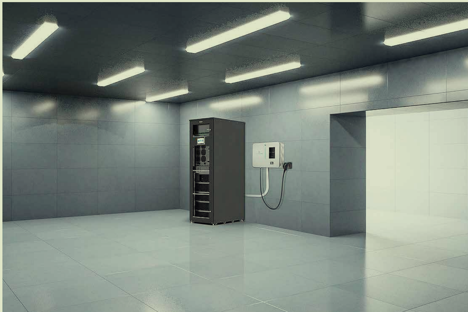
← Her ser vi et eksempel på et batterilagringssystem fra leverandøren Eaton.
