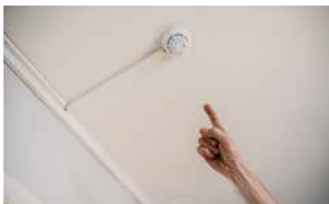
Detektoren til det mobile slokkeanlegget er montert i taket.
