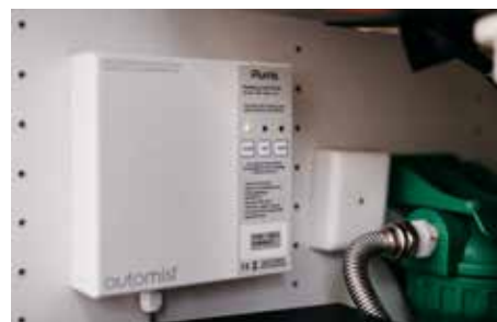
Det mobile slokkeanlegget har en egen liten sentral montert under vasken.
