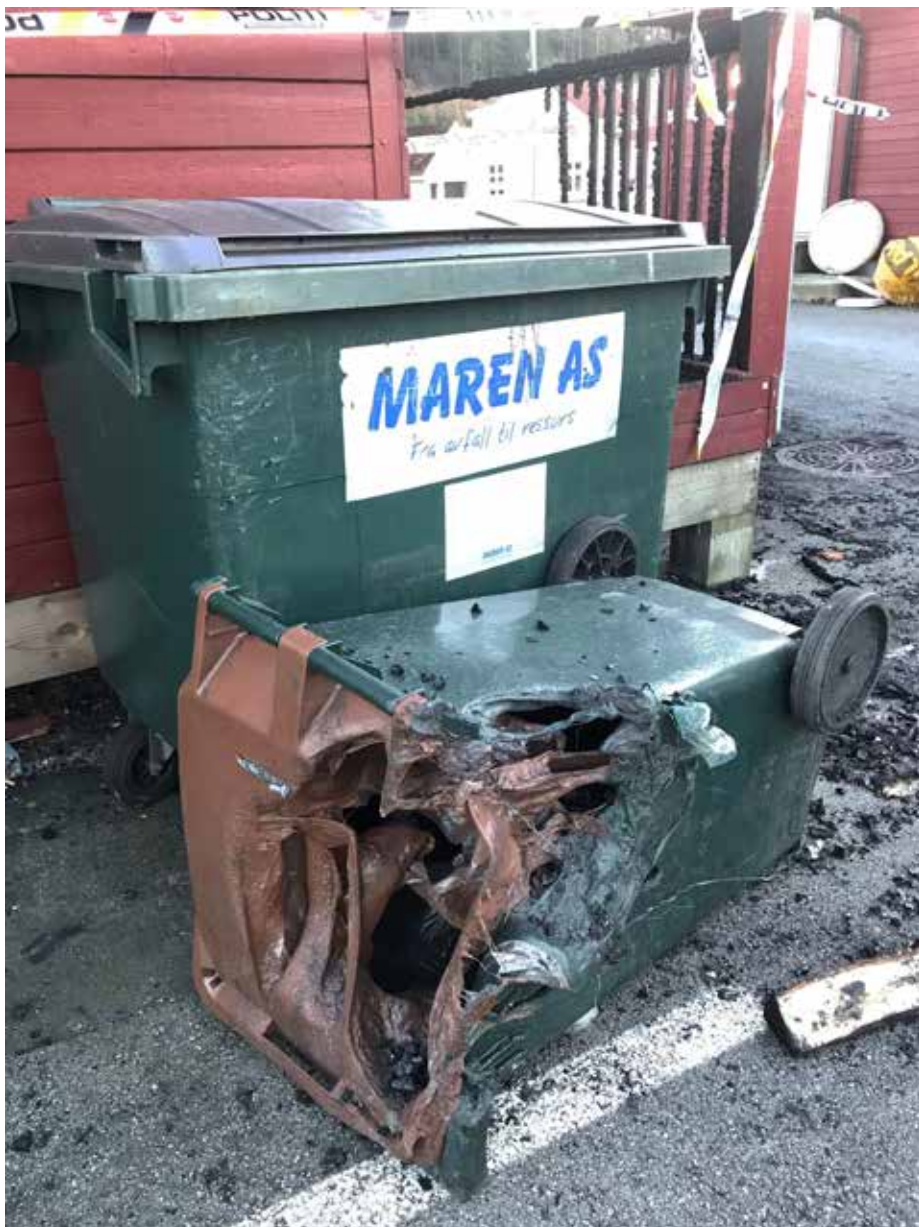
Avfallsdunker og containere er en potensiell brannfare. Å flytte slike beholdere til egne skur er et enkelt, forebyggende tiltak.
