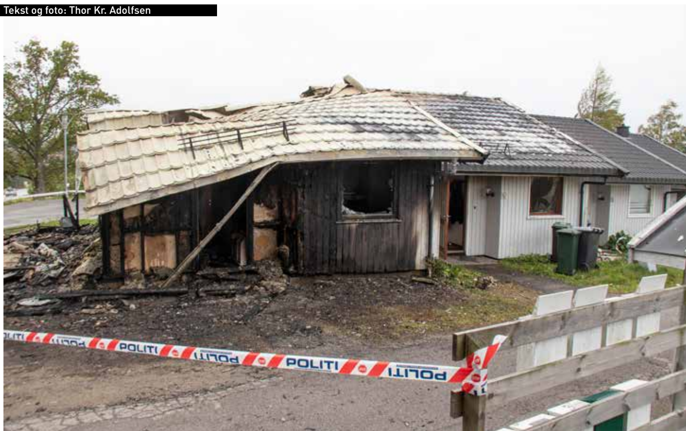
Råde kommune har hatt tre store branner i kommunale leiligheter. To av brannene var i 2007. Bildet viser skadene fra brannen i september 2018.
