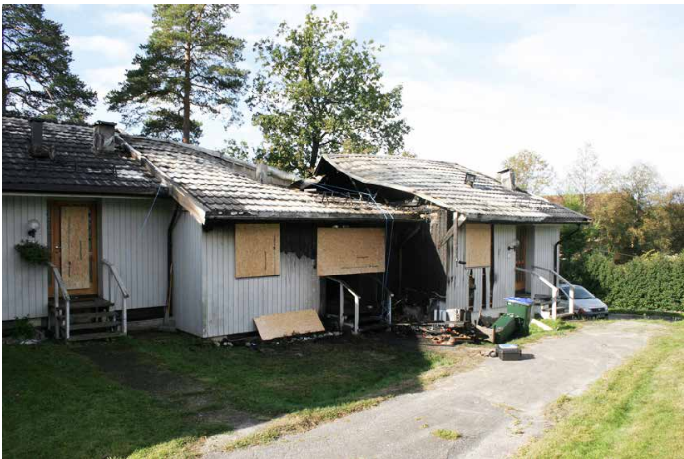
Skadene fra den andre brannen i 2007. Brannspredningen skyldtes blant annet manglende brannskiller på loftet. Dette var ikke utbedret i tilsvarende bygninger da det brant i 2018.
